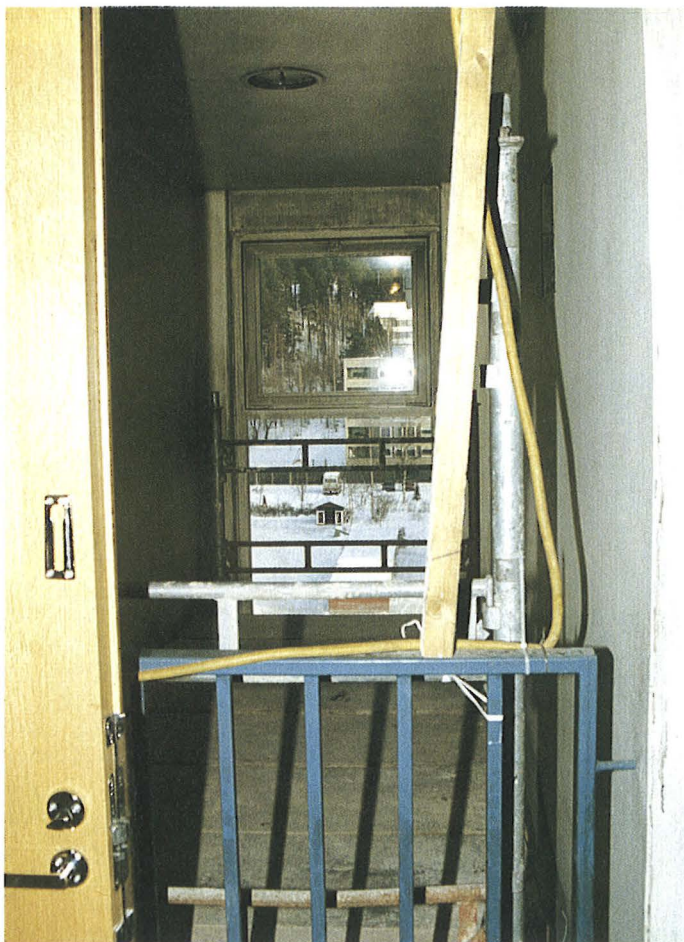
Porraskäytävän kummallisuuksia on erillinen kuilu, jonka ylimmässä osassa on avattava ikkuna. Avaaminen edellyttäisi kuitenkin kolmen metrin varrella varustettua avainta ja rikkominen yhtä pitkää työkalua! Kuvassa kuilun peittää saneeraustöitä varten rakennettu työskentelytasanne.
