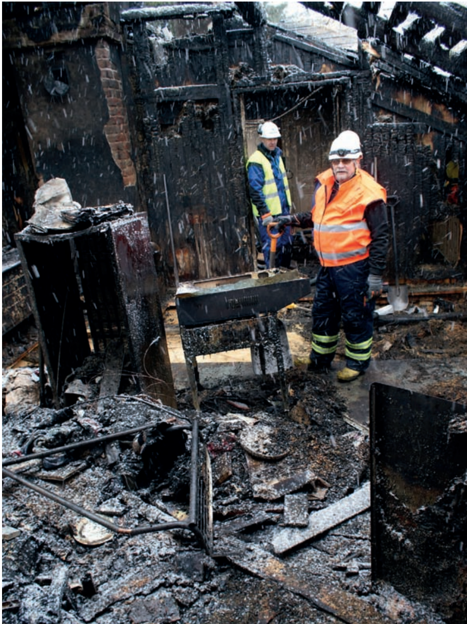
Poliisin ja pelastuslaitoksen tutkijat paikallistivat todennäköiseksi palon syttymispaikaksi hormin halkeaman toisen ja kolmannen kerroksen välipohjan kohdalla.
