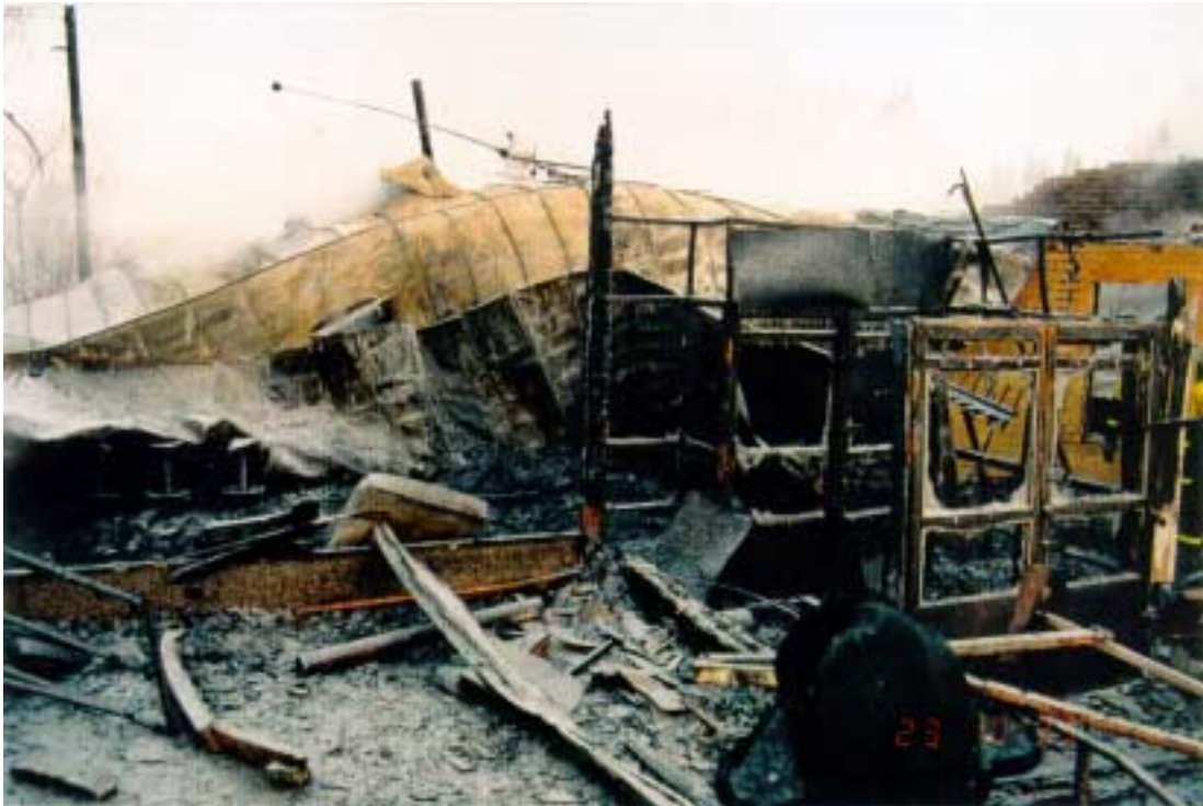
Tuhoutunut rakennus 23.12.1995 ennen raivausta sisääntuloaulan kohdalla idän/ tien suunnasta kuvattuna. Kuvan oikeassa reunassa on pääsisäänkäynti hotelliin ja ravintolaan.
