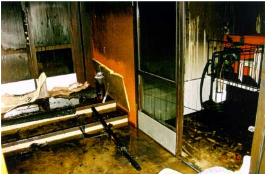
Palo-ovia uuden majoitusosan yläkerrassa. Vasemmassa reunassa näkyvä palo-ovi johtaa vanhan majoitusosan käytävään ja se suljettiin sammutustyön aikana. Auki oleva palo-ovi johtaa porrastasanteelle, josta on vasemman kautta käynti uuden majoitusosan alakertaan. Huom. seinissä ja ovissa erottuu kuumuuden ja savupatjan jättämä raja (vertaa yläkuvaan vanhassa majoitusosassa, jossa raja on vastaavalla korkeudella).
