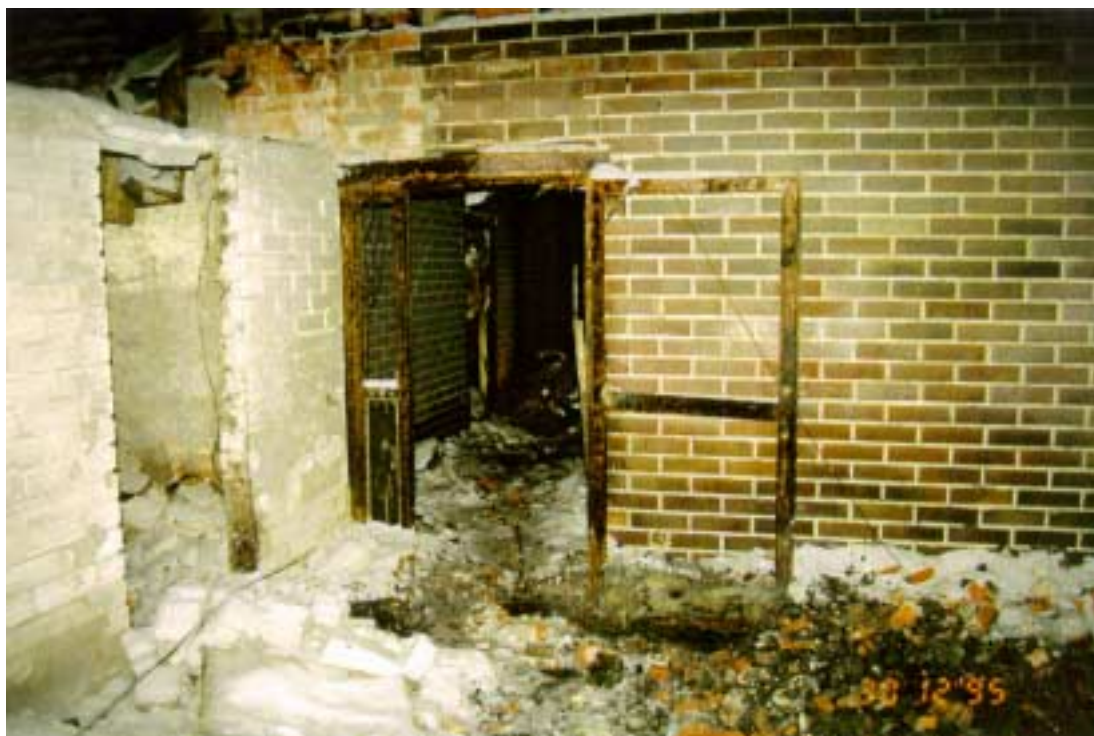
Sisääntuloaulan vieressä olleen takahuoneen ja vanhan majoitusosan käytävän välissä palon aikana ollut palo-ovi. Vertaa 2.11.1995 kuvatulta videonauhalla otettuun valokuvaan auki olleesta palo-ovesta kohdassa 3.5.
