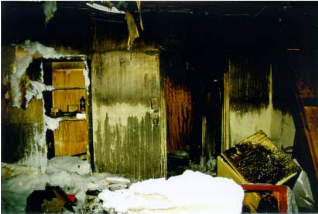
Menehtyneen remonttimiehen huone 6 tulipalon jälkeen kuvattuna ikkunan suunnasta. Kuvan keskivaiheilla on oviaukko vanhan majoitusosan käytävään.
