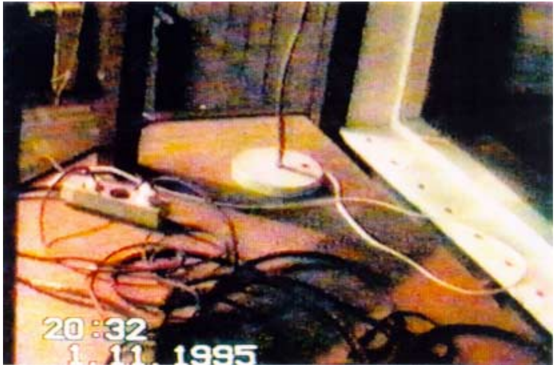
1.11.1995 kuvatulta videonauhasta otettu valokuva esimerkiksi ravintolan sähköjärjestelystä.
