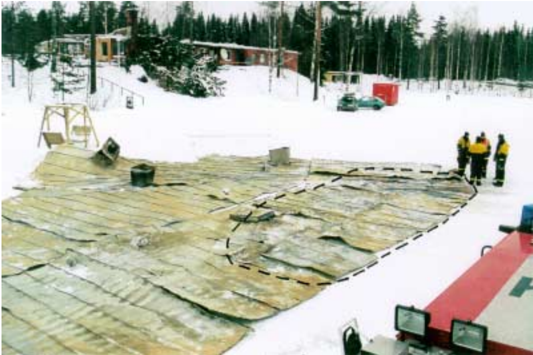
Ravintolan kattopellit rekonstruointiin 3.2.1996 tapahtumapaikalla, jolloin todettiin poikkeavia värimuutoksia kattopelleissä sisääntuloaulan kohdalla. Kyseinen kohta on kuvan keskiosassa ympäröitynä katkoviivalla.
