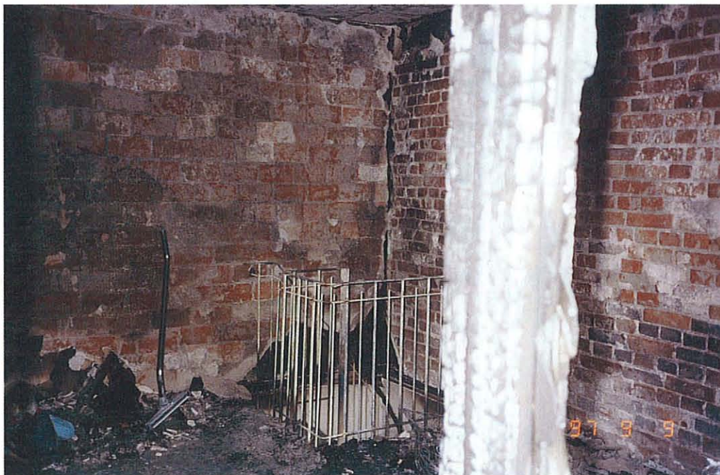
Kuva parvekkeelta asuntoon. Rappausta myöten kaikki on palanut. Nurkassa kierreporras asunnon alemmaan kerrokseen.
