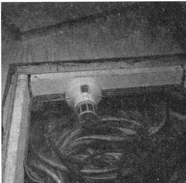
Korotettuun lattiaan tehty aukko, johon on sijoitettu savunilmajaisin.
