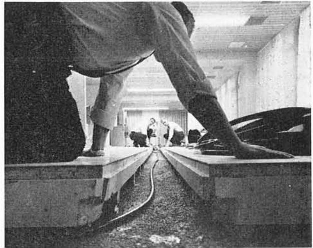
Koneiden väliset kaapelit sijoitetaan usein korotettujen lattioiden alle. Tällaisten lattioiden paloteknilliseen rakentamiseen on kiinnitettävä erityistä huomiota.
