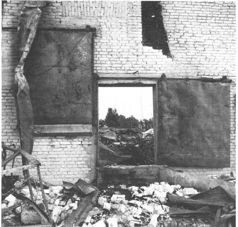
Lähtetästä (rakennus 2) oli eri tasoissa yhteensä neljä palo-ovella varustettua yhteyttä viereisiin varastoihin (rakennukset 1 ja 4). Työajan päätyttyä avoimiksi jääneet 2 palo-ovea eivät sulkeutuneet automaattisesti palon aikana, eikä niitä myöskään palohenkilöstön toimesta ehditty sulkea palon leviämismopeuden vuoksi.
