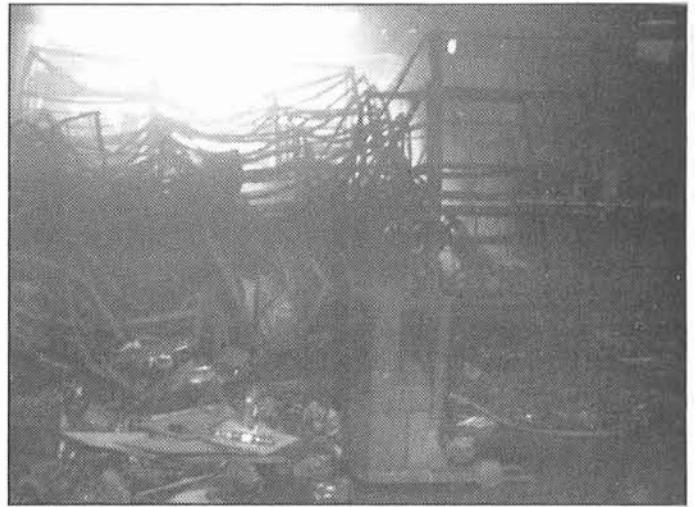
Kuva 3. Savun keskellä hämöttäviä sortuneita ja taipuneita metallirakenteisia varasto- hyllyjä. Taustalla sortuneen katon muodostama valoaukko.
